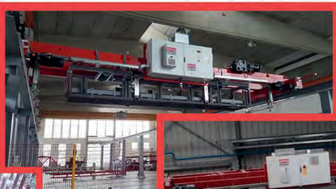
Puentegrúa apilador en interfaz con almacén automático
