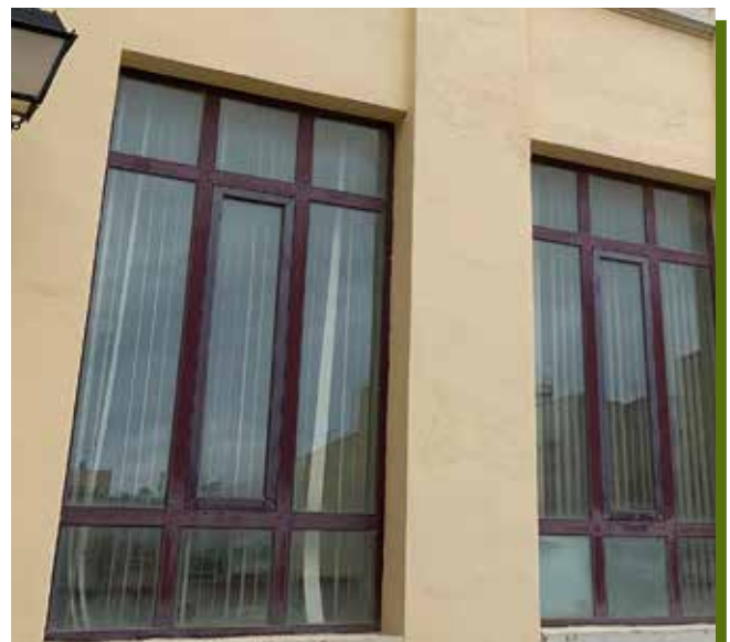
Carpintería metálica deteriorada en el Colegio Público Marqués de Bernicarló
