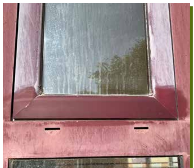
Actuación realizada en el Colegio Público Marqués de Benicarló. Detalle de la carpintería afectada y empezada a tratar en el centro con Façade CR-0000.
