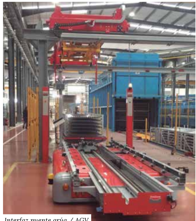
Interfaz puente grúa / AGV
